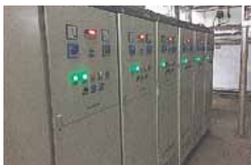
◀連結モジュール型高効率チラーシステムを導入
