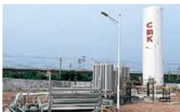
◀天然ガス切り替えのために設置したLNGタンク
