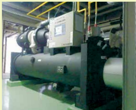
更新した高効率ターボ冷凍機
