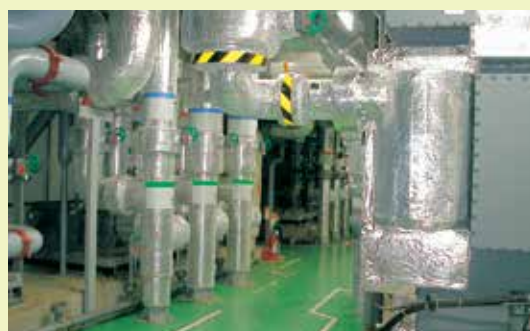
変流量システムポンプ群
