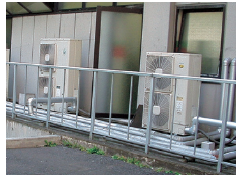
新たに導入した空調機
