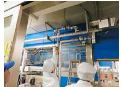
工場設備の省エネ診断
