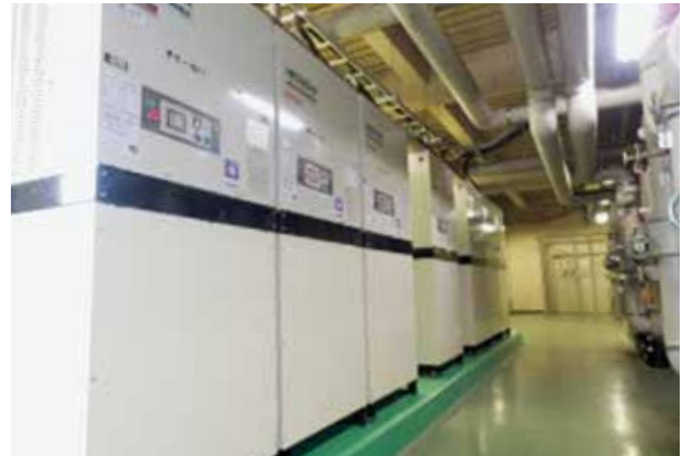
更新した高効率連結モジュールタイプチラー
