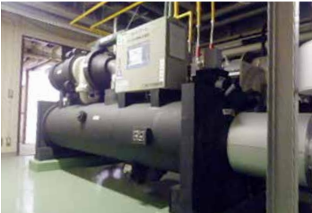
更新した高効率ターボ冷凍機
